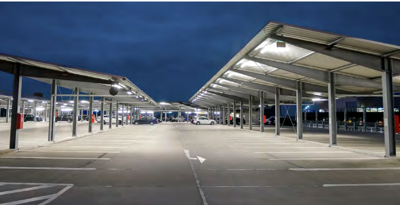
Bedarfsgerechte Steuerung der Leuchten auf dem Parkdeck
