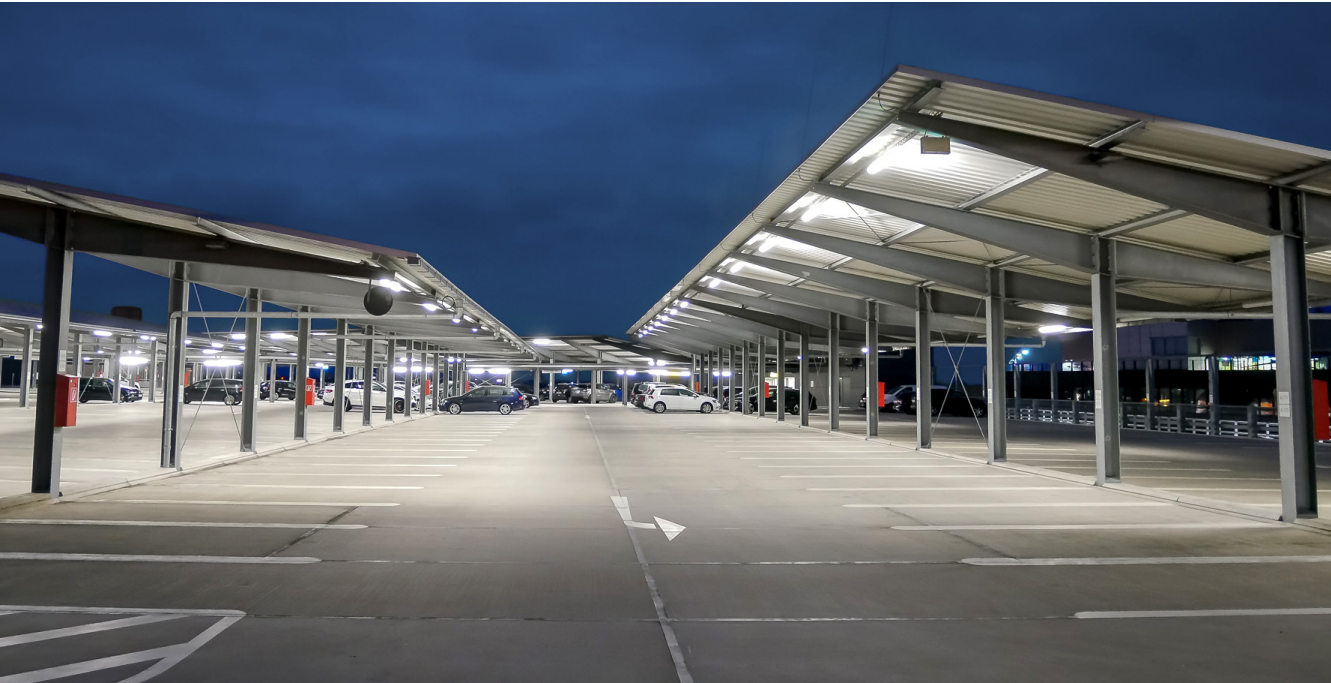
Bedarfsgerechte Steuerung der Leuchten auf dem Parkdeck
