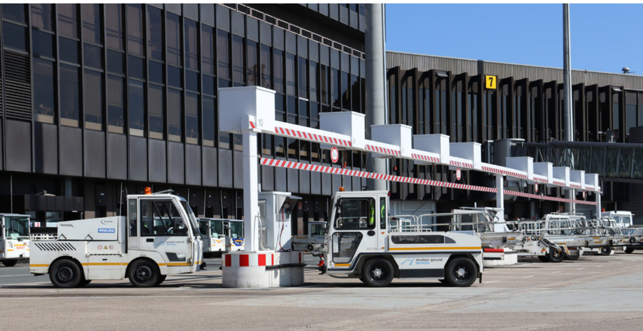
E-Ladestation für Vorfeldfahrzeuge zwischen Terminal A und B
