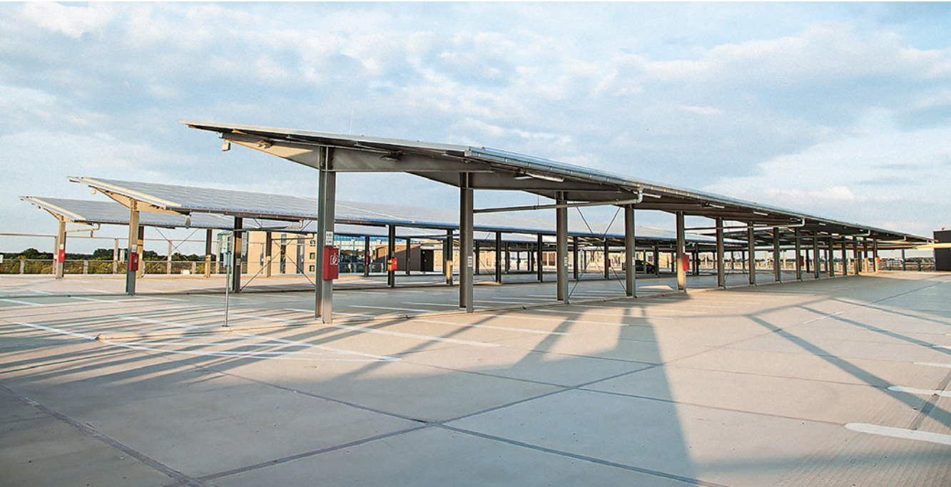
Eine der größten Photovoltaik-Anlagen der Region – am Hannover Airport auf Parkhaus 1
